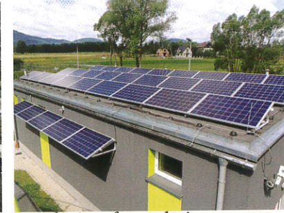
Instalacje fotowoltaiczne na obiektach ETS
