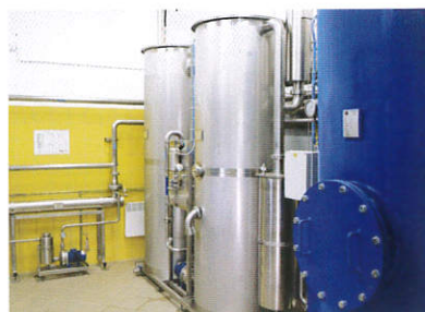
System ozonowania wody SUW w Łodygowicach
